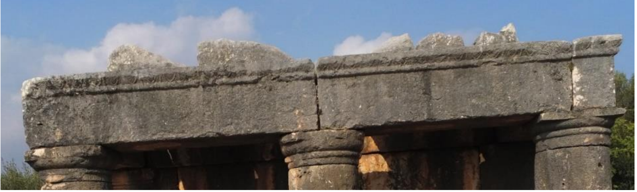
Şekil 7. Anıtmezar süslemelerinde gözlenen form kaybı
